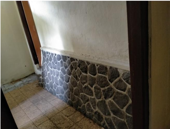
Gambar 18. Dinding luar bangunan asli di sisi kiri dan belakang dengan batu alam, yang kini terletak di bagian dalam dari bangunan tambahan baru
